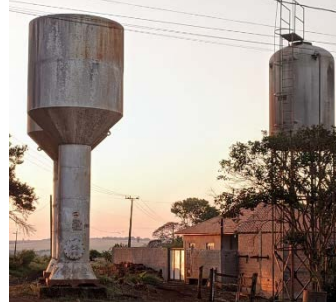
Imagem 2: Rede de captação de poço artesiano
