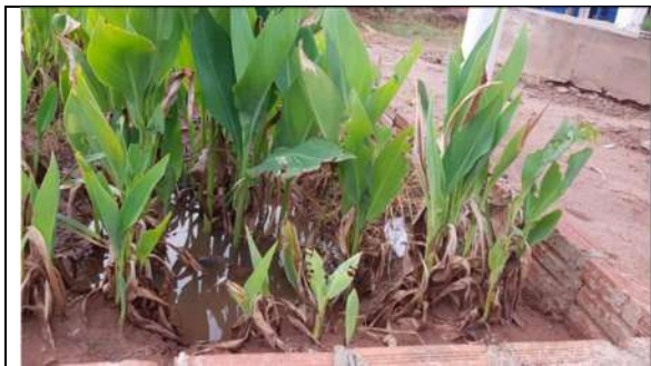
Figura 5a: BET com afundamento e alagamento.
